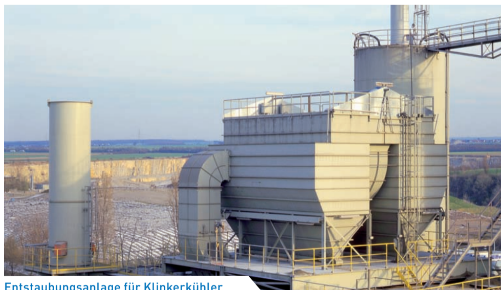
Entstaubungsanlage für Klinkerkühler Rechts sieht man ein Silo mit einem Münstermann-Rundfilter, links direkt am Filter kann man sehr gut die Zuführung des Rohgaskanals erkennen. Zwischen den beiden Filterkammern ist der Reingaskanal installiert.
