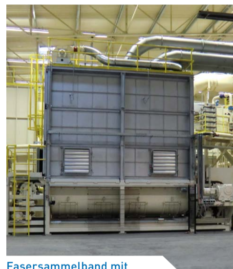
Fasersammelband mit Zuleitung und Abluftsystem
